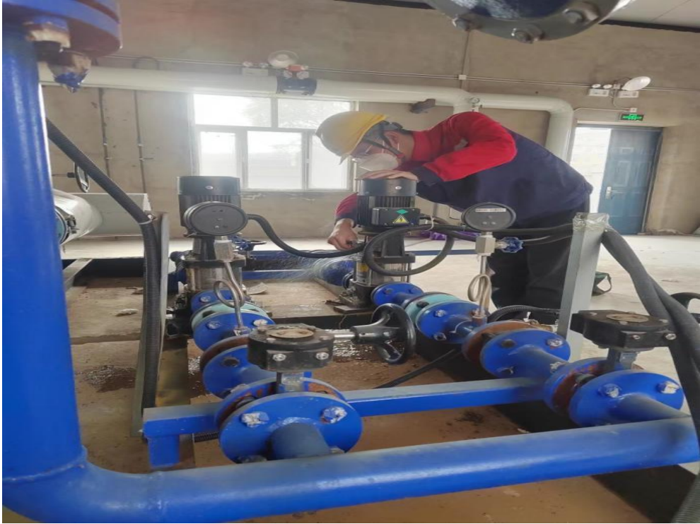
图56 张家口宣化城区集中供热工程换热站
