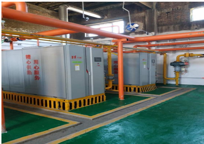
图59 雄安新区安新城区“煤改气”燃气锅炉
